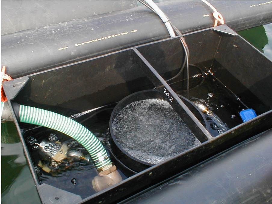
Abb. 5: Sauerstoffanreicherung des Tiefenwassers durch einen Tellerbelüfter
